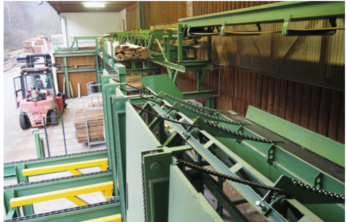
An der Hallenaußenseite montierte WDT drei zusätzliche Abwürfe sowie ein Kippentstapelung für die Nachsortierung
